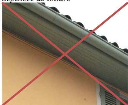
les dépassées de toitures lambrisées sont proscrites...
