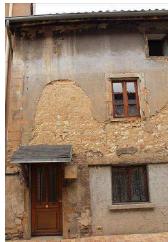
exemple de façade déstructurée
