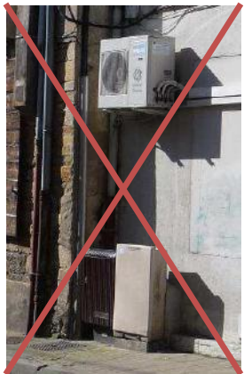
Appareils divers en applique sur la façade
