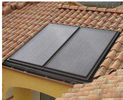
exemple de panneaux solaires thermiques
