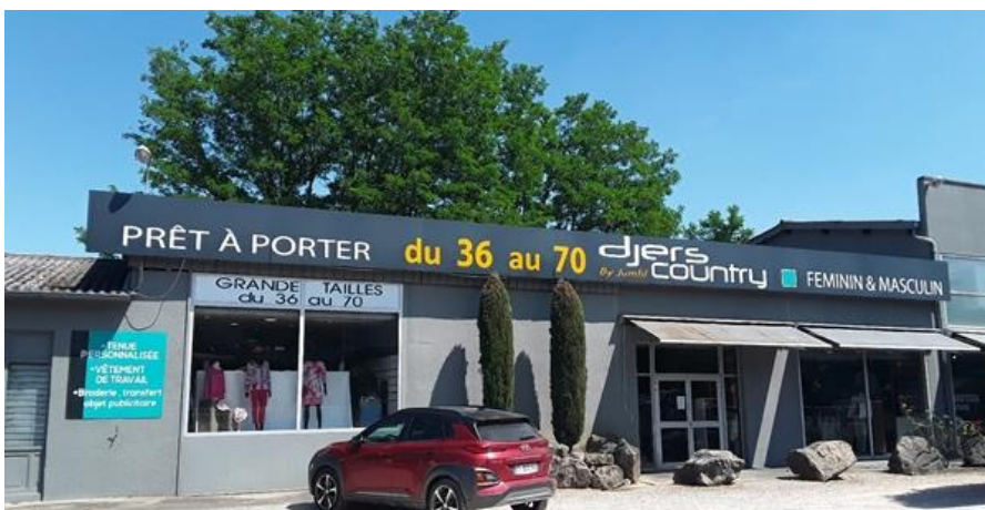
Enseigne sur toiture (illégal : lettres non découpées)
