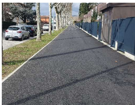
Piste cyclable en enrobé poreux Bd Leclerc à Villefranche-sur-Saône (source : SEPIA Conseils)
